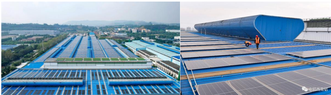
屋顶光伏发电
